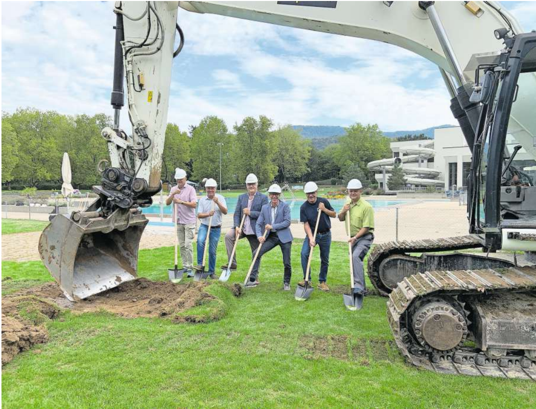
Wieder ein Spatenstich im Tägi: Im Gartenbad werden die Becken mit Chromstahl ausgekleidet und die Technik erneuert. Bild: Andreas Fretz
